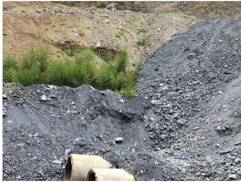
未按要求弃渣，平铺压实
